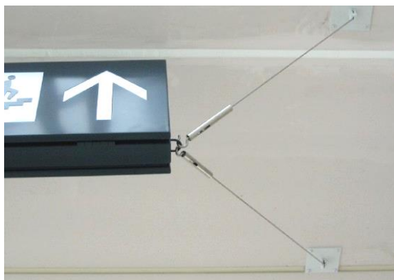
駅構内振れ止め
